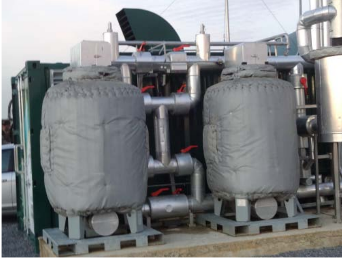
L'unité d'épuration. Source ALE 08
