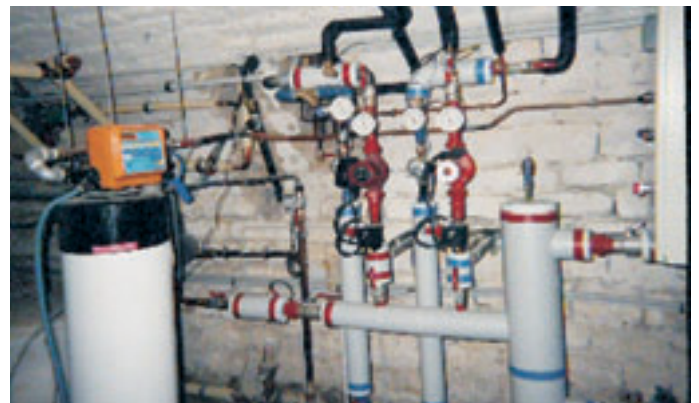
La sous-station de la maison Caillet
